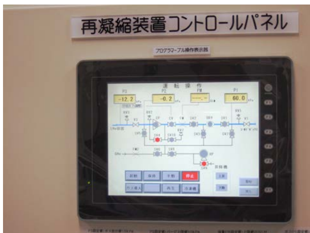
図7. ヘリウム液化装置制御盤置
