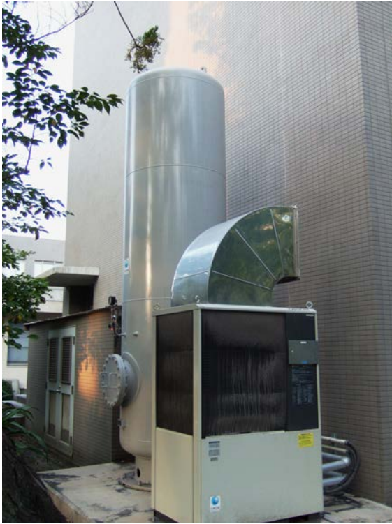
図3. 101室に隣接した屋外に設置された冷却水循環装置（手前）、5 m 3 ストレージタンク（中央）とポンペ庫（奥）
