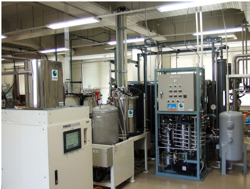
図2. 101室に設置されたヘリウム液化装置
