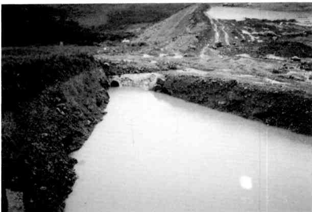
第6図 造成区域外の雨水排水溝用沈砂池。
