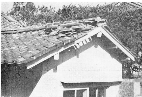
第3図 下葺まで飛散した日本瓦葺屋根
