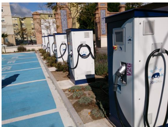
図2 電気自動車用充電設備
