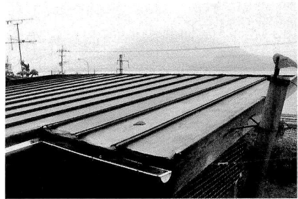
図20 金属屋根の軒先部分の腐食状況
