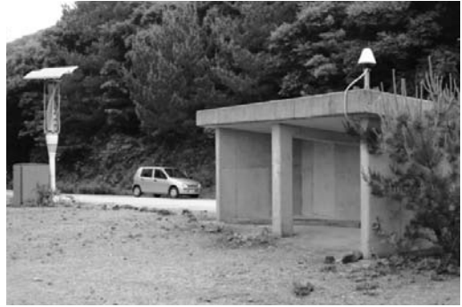
写真2. 火山ガス測定装置と避難施設
