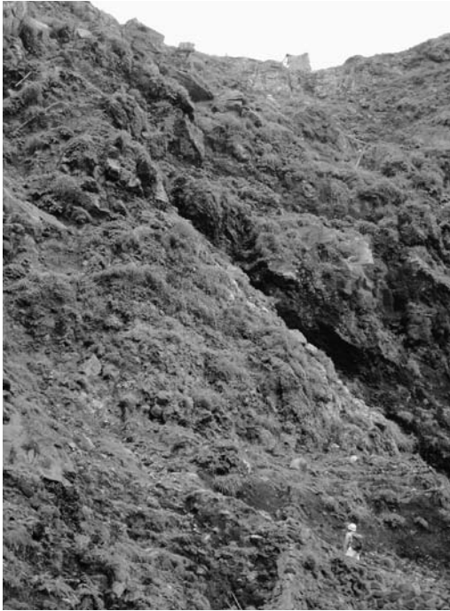
写真17. 荷揚げするにも直接釣り上げ困難
