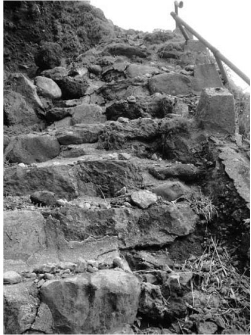
写真18. 崩れていないところでもこの状態
