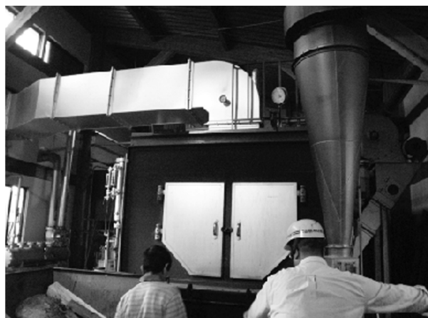
写真-1. 木くず焚きボイラー
