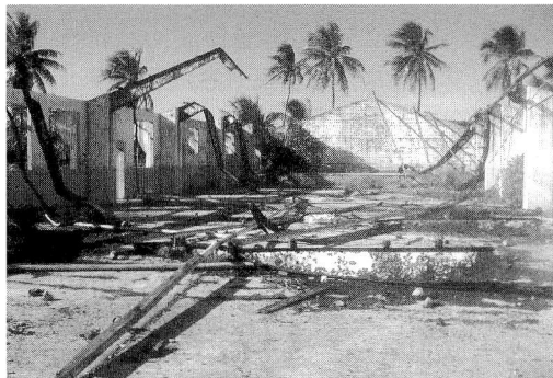
台風により上部構造物が吹き飛ばされたままのユリティ環礁ファララップ離島高校体育館
