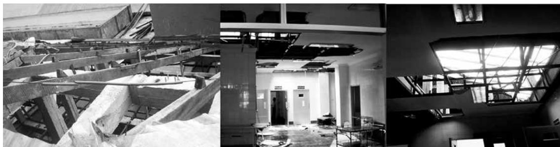
2008年サイクロン・ナルギスにより天井が吹き飛ばされたヤンゴン歯科大学の手術室
