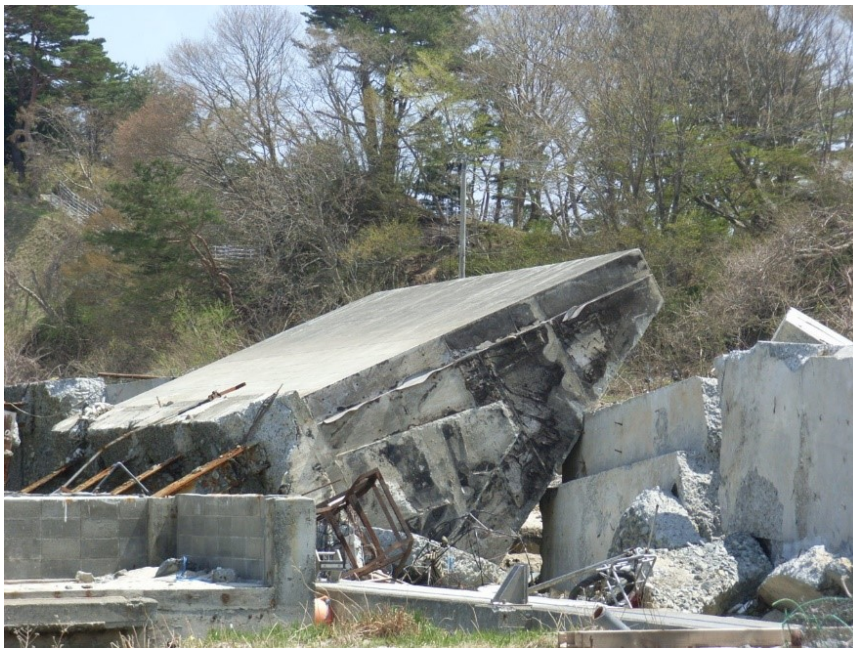
写真 5.4 防潮堤の倒壊事例
