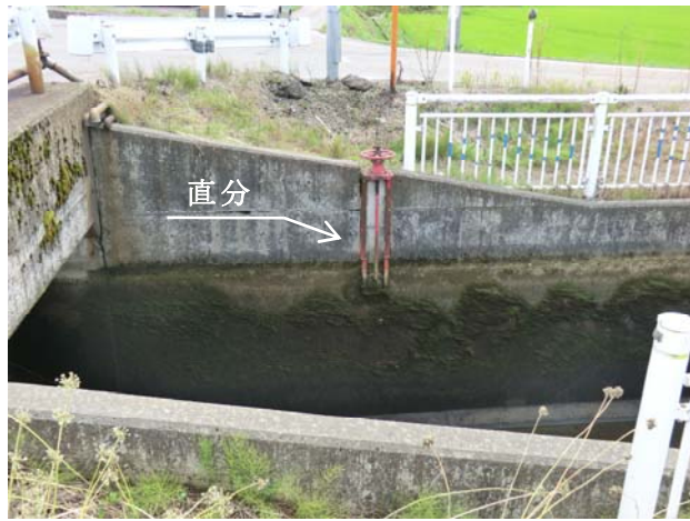
Fig.5.4 直分の状況 Direct outlet
