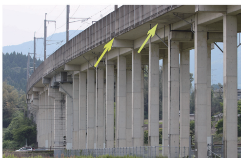
図2. B地点の新幹線高架橋。橋脚上部における橋梁接合面のスリット(矢印)がコウモリ類のねぐら場所として利用されている。
