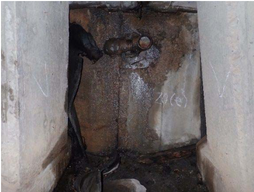
写真 6.18 漏水跡(端部横桁)
