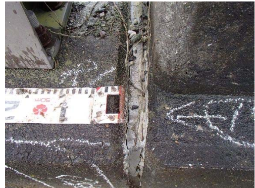
写真 6.21 地覆目地材(2期施工)
