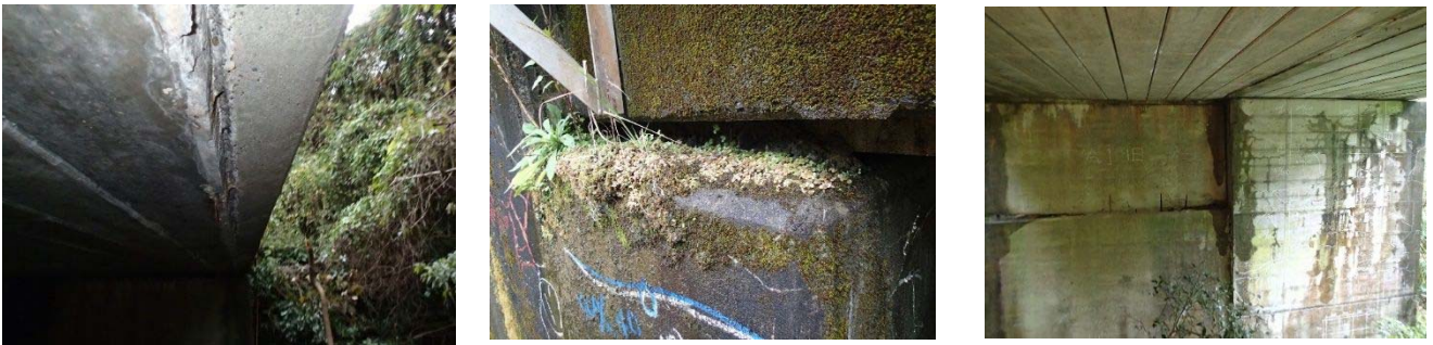
写真 6.15 桁端部の損傷
