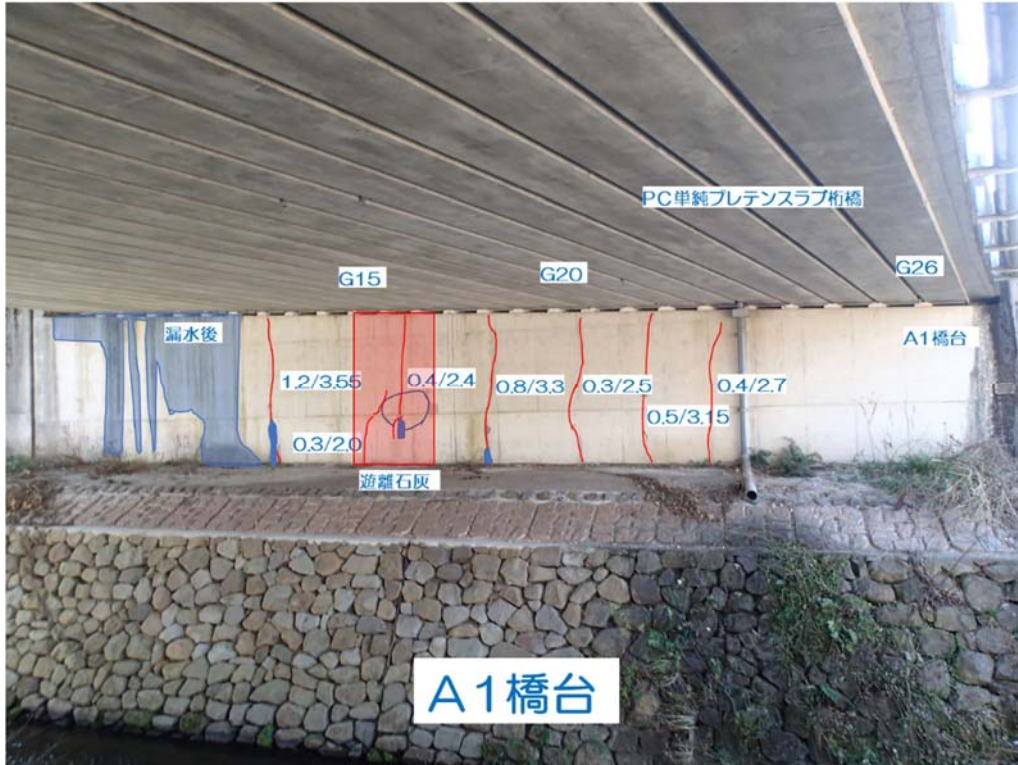
写真 6.8 対象橋梁橋台の損傷写真
