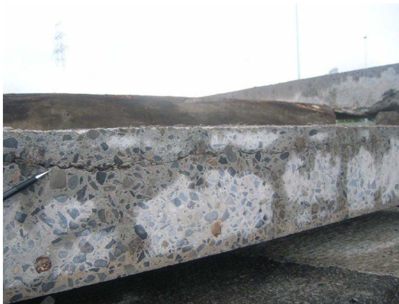
写真 2.5 水平ひびわれ（上面鉄筋位置に多い）
