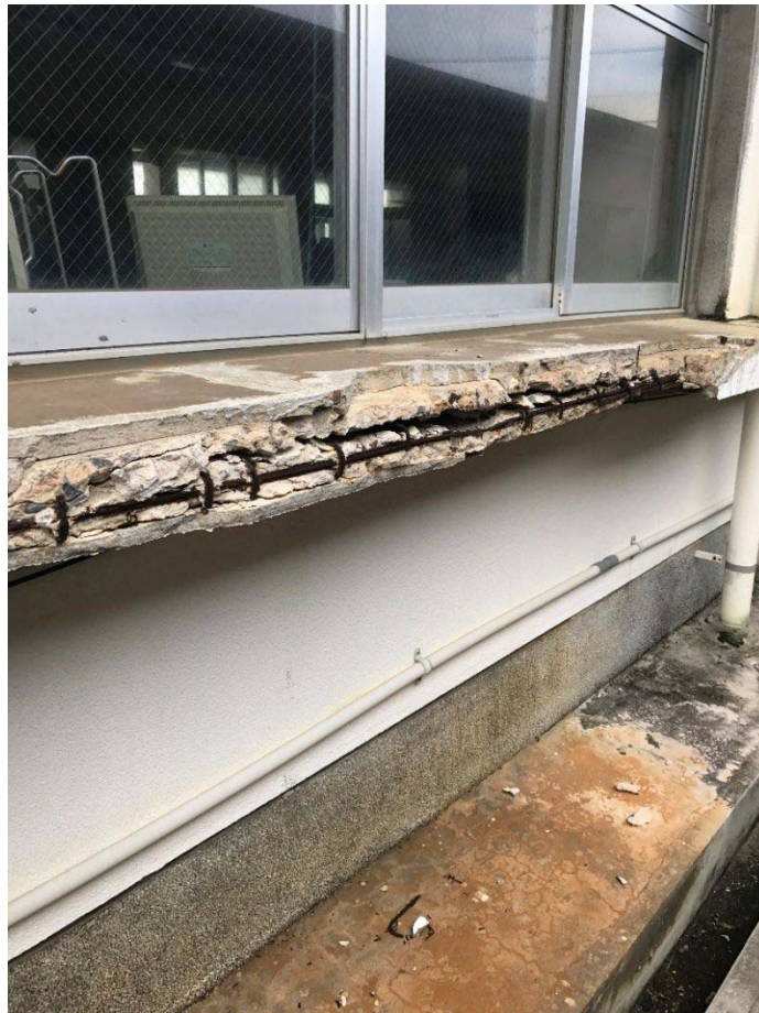
写真 3.1 与論庁舎(海岸から約 80m)の劣化状況
