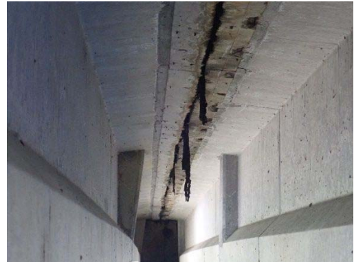
写真 6.19 伸縮装置劣化状況(1期施工と2期施工の継目部)
