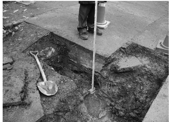
2016-H 配管漏水状況
