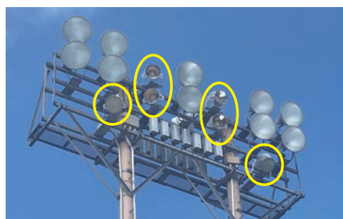
図4-34 教育学部球技場に設置されたFGHPライト6灯(黄丸内6)
