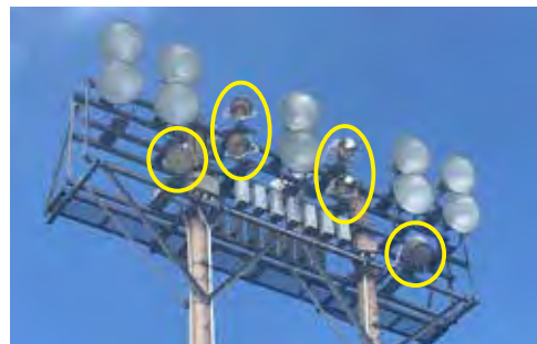
図4-5 教育学部球技場に設置されたFGHPライト6灯（黄丸内6）
