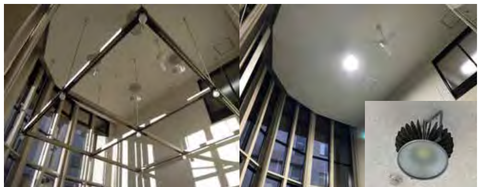
図4-6 旧照明設備（上：水銀灯4灯+蛍光灯12本）、新照明設備（下：FGHPライト1灯）の比較
