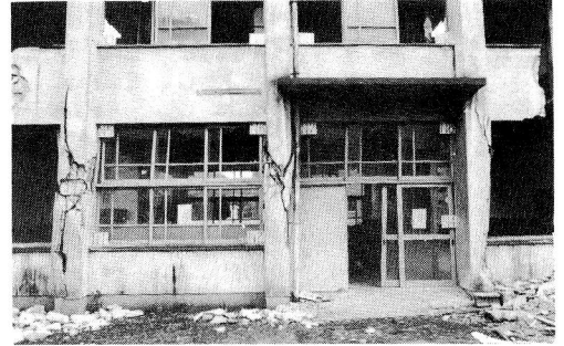
写真-3(b) N 通り柱の最終亀裂状況
