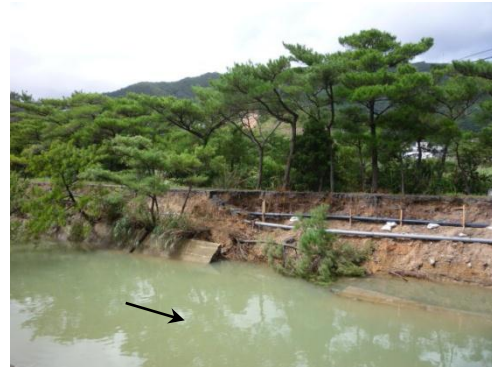
写真-4 浦川左岸の被災状況
