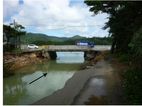
写真-2 被災後の浦川河口の状況
