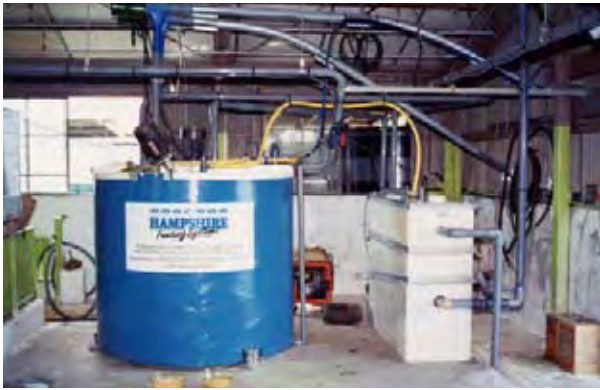
写真3 リンスタンクと混合攪拌タンク
