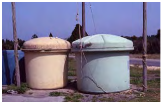
写真2 焼酎粕 SUB タンクと焼酎粕 MAIN タンク
