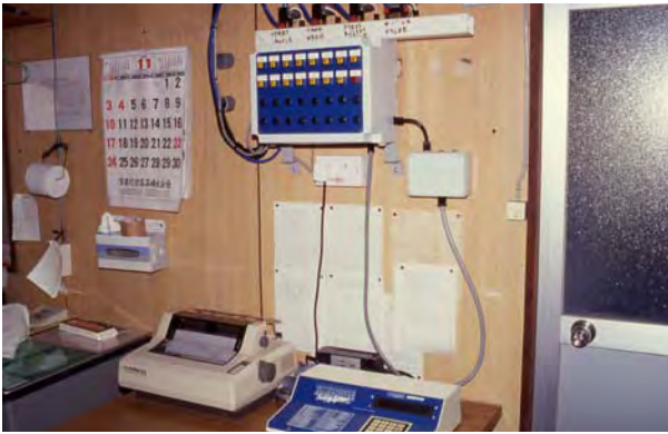
写真11 制御用コンピュータおよび附属機器
