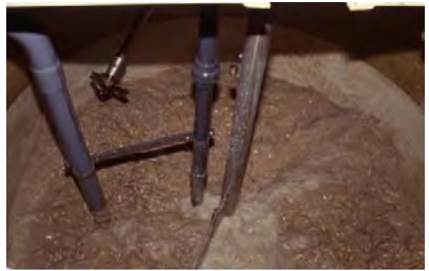
写真4 混合攪拌タンク内部：混合状況
