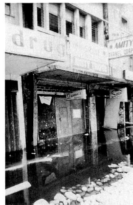
Photo 12 (d) Subsidence of residential house
