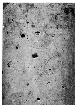
【No. 2 碎石使用】 アルカリ骨材反応特有のマップ状のひび割れの発生ならびに少量の浸出物（白い斑点）が観察された。
