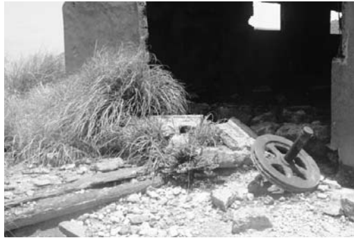
写真5. 東側策道けん引施設
