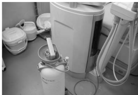
写真24：水がでないのでタンクに水を溜めて使用
