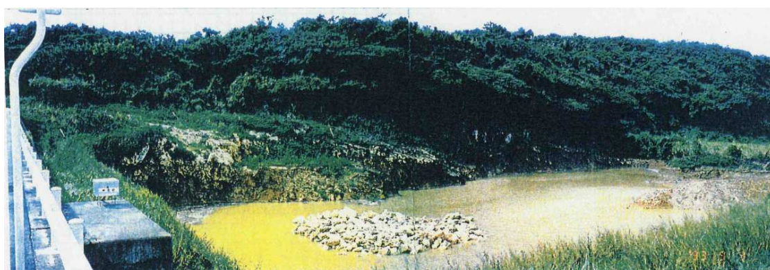
写真2-5: 施工中の1号浸透池の湛水状況。1993年9月1～3日降雨(連続降雨108.5mm)。左は県道7号。後方の林帯は米須断層。1993年9月3日撮影
