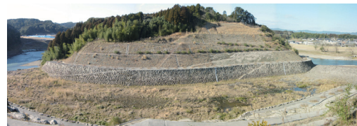
図 2. 完成した推込分水路。
