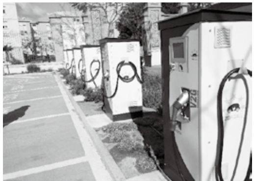
図2 電気自動車用充電設備
