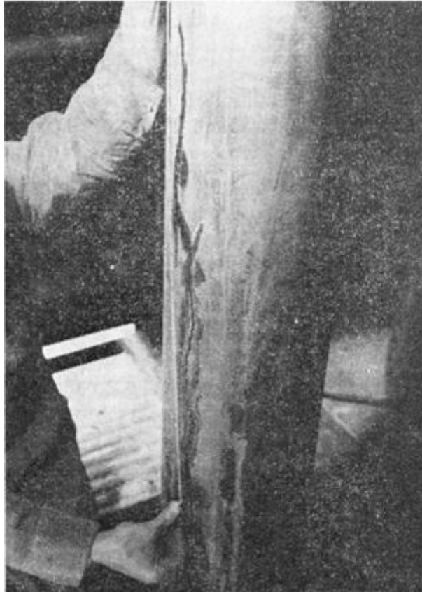
図 1-6 蒸気漏洩後のボイラ主蒸気管の写真 7)
