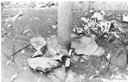
図35 柱脚部の抜出し
