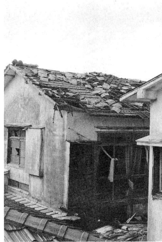
図44 瓦の被害例（鹿児島県提供）
