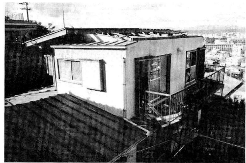
図7 鉄板屋根の被害（鹿児島市提供）
