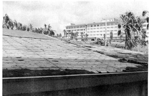
図16 アスファルトシングルの吹き飛び(鹿兒島県提供)
