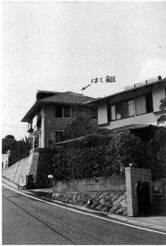
図47 石綿スレートのはく離 (棟付近)
