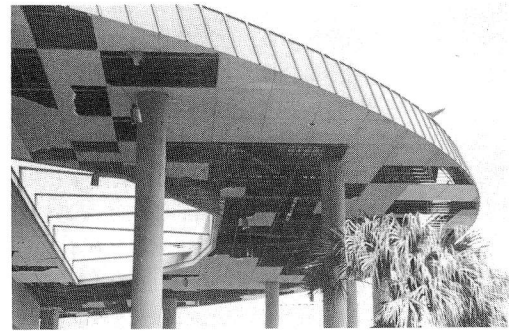
図12 軒天井被害（鹿児島県提供）
