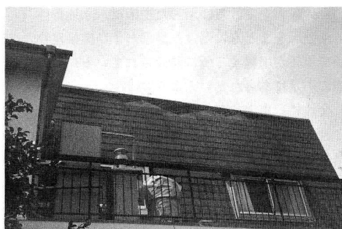
図49 急勾配屋根の石綿スレート
