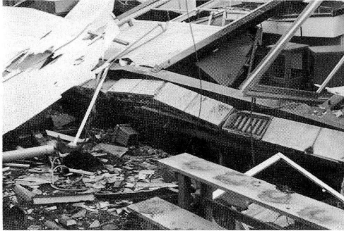
図23 コンクリートブロック布基礎の浮き上がり
