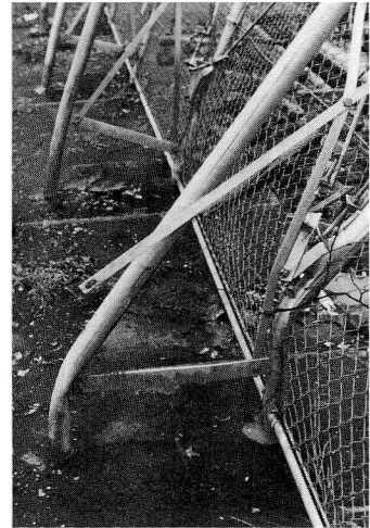
図38 腹材の座屈およびボルトの破断
