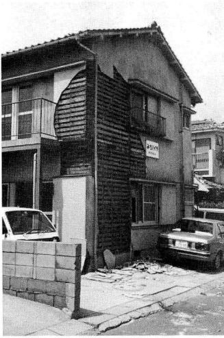
図8 モルタル壁のはく落
