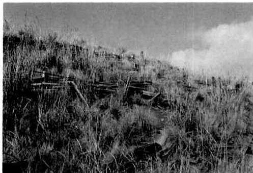
第1図 肥育牛舎建築予定地の造成で、盛り土が崩壊した部分。
