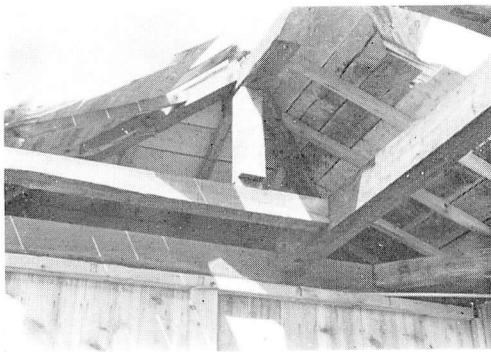
第18図 束を引抜かれた公庫住宅 (古仁屋)
