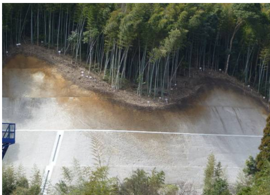
写真 5.4.1 露頭したしらすの風化状況(鹿児島市西別府町)
