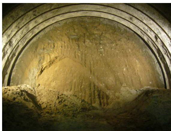
写真 4.3.4 ふつうしらす切羽の崩落(2) (区間①)
