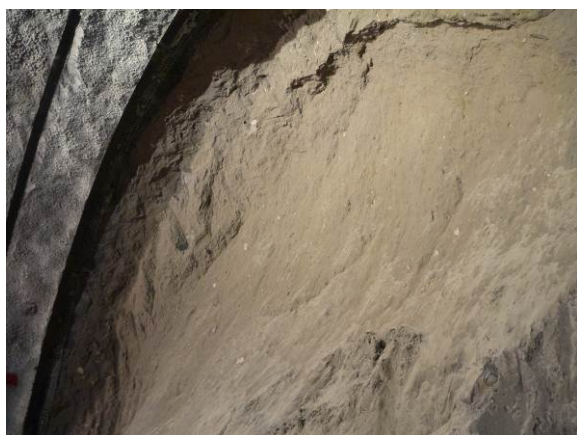
写真 4.3.7 土被りの大きい切羽の崩落 (1) (区間⑤; 2 車線断面)
