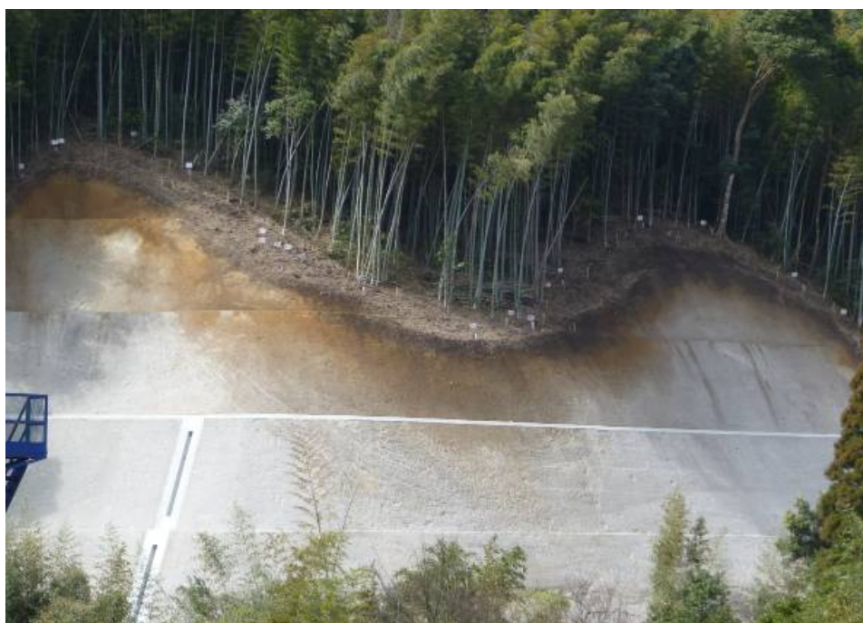
写真 2.5.1 露頭したしらすの風化状況 (鹿児島市西別府町)
