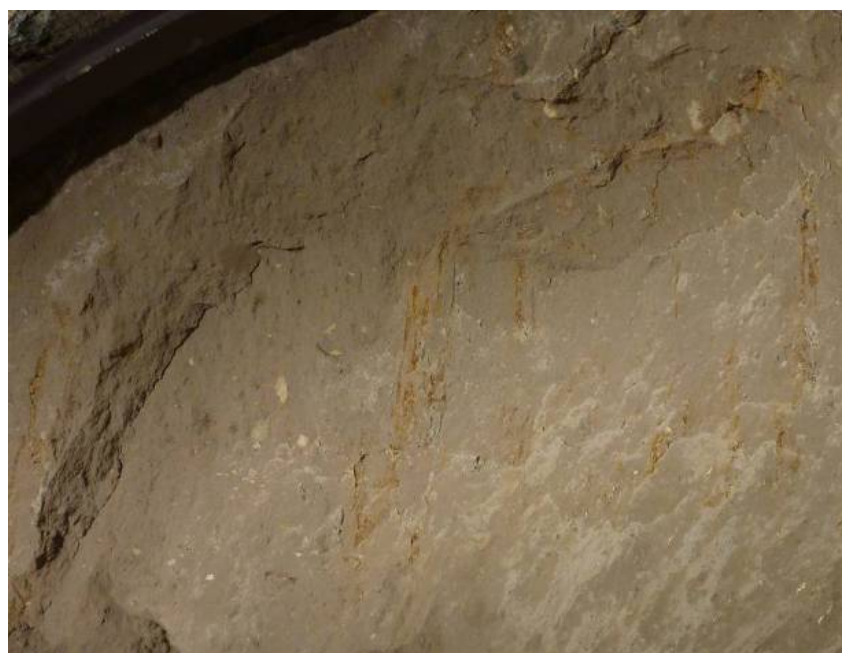
写真 4.4.1 トンネルの切羽の割れ目に沿った風化（区間②）
