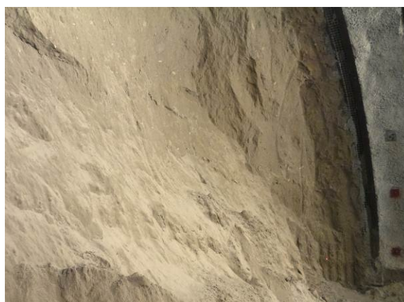
写真 4.3.8 土被りの大きい切羽の崩落 (2) (区間⑤; 2 車線断面)
