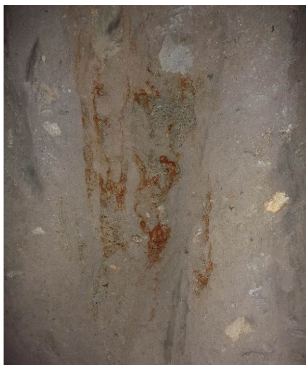
写真 4.4.2 一次しらす中の風化面(1)
