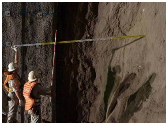
写真 4.3.10 土被りの大きい切羽の崩落 (4) (区間④; 導坑上半断面)
