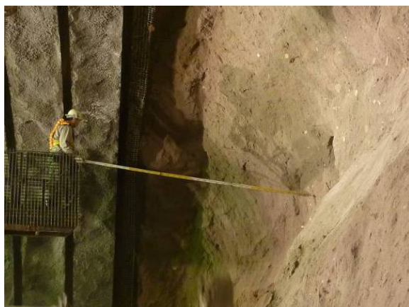
写真 4.3.9 土被りの大きい切羽の崩落 (3) (区間⑤; 3 車線断面)
