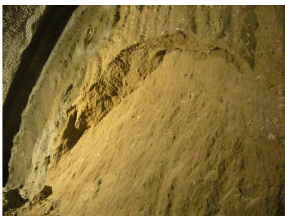
写真 4.3.3 ふつうしらす切羽の崩落(1) (区間①)
