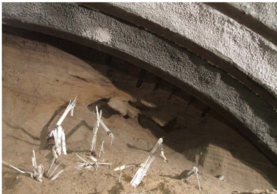
写真 4. 4. 7 二次しらす切羽の崩落
