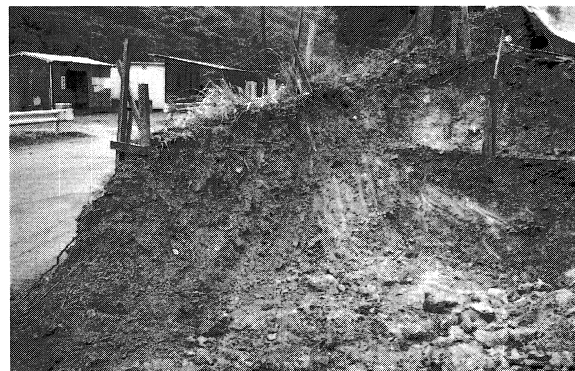
写真-6 住用村役勝川中流部付近の斜面
