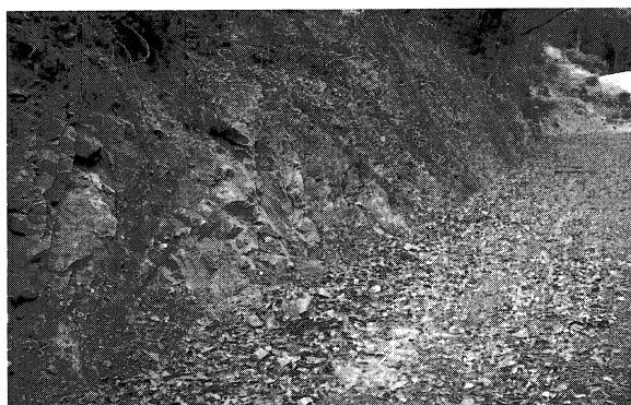
写真-3 瀬戸内町高丘の大当原ダム付近の斜面
