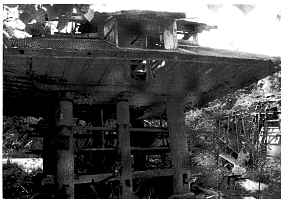
持ち主不在の高倉（和泊町古里） 白蟻の被害にあっている
