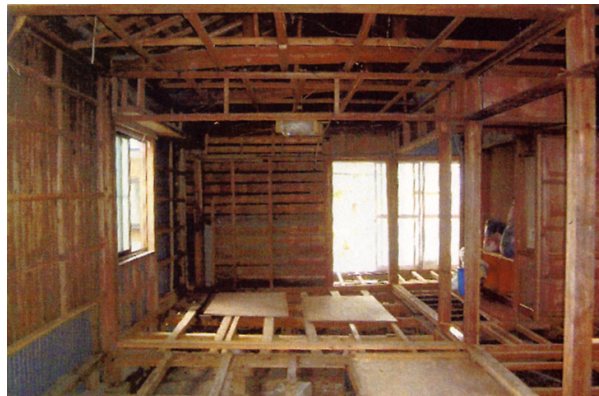
写真一2 建物の被害
